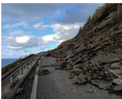
【1月2日撮影】 【寸断された道路】
