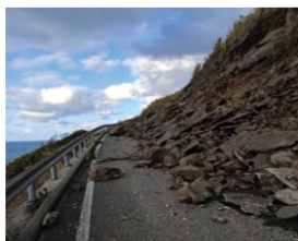
【1月2日撮影】 【寸断された道路】
