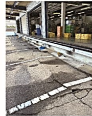
▲ 陥起したのとセンター 断水が続いています
