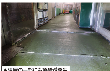
▲建屋の一部にも亀裂が発生
