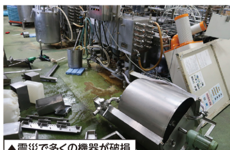
▲震災で多くの機器が破損
